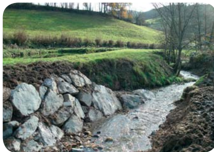
Enrochement sur le Botoret
